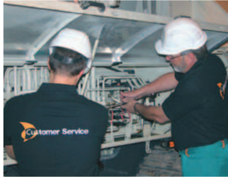
Las inspecciones regulares ayudan a evitar averías mecánicas y eléctricas y a aumentar la disponibilidad de los equipos.
