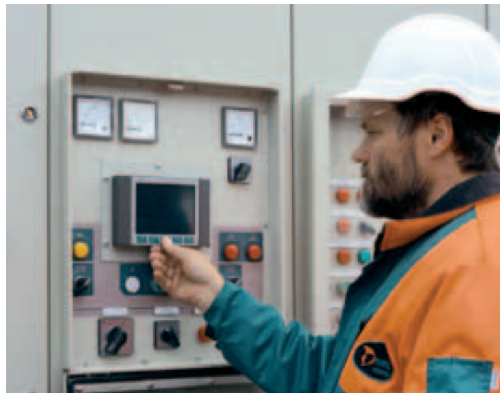
Unidad de automatización IC50 instalada en una planta de trituración móvil Lokotrack.
